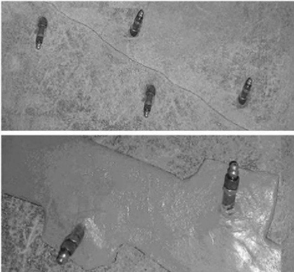
Figuur 1: busvormige nippels geplaatst rond de scheur en afgedicht met een aangepaste epoxylijm uit het MasterInject gamma.
